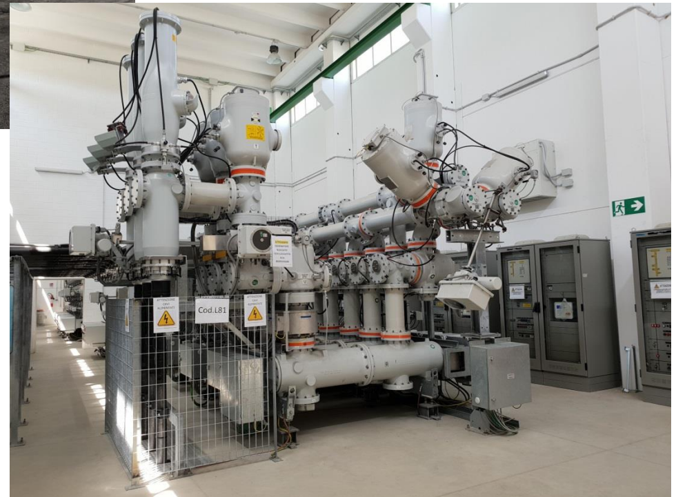
Sezionatori a gas inerte (Gas Insulating System)
